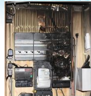
Installatie na kortsluiting
