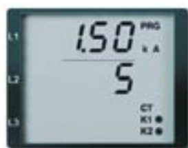
Programmeren van overzetverhouding stroomtrafo
